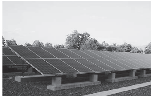
山腹には巨大なソーラーパネルも設置されています
